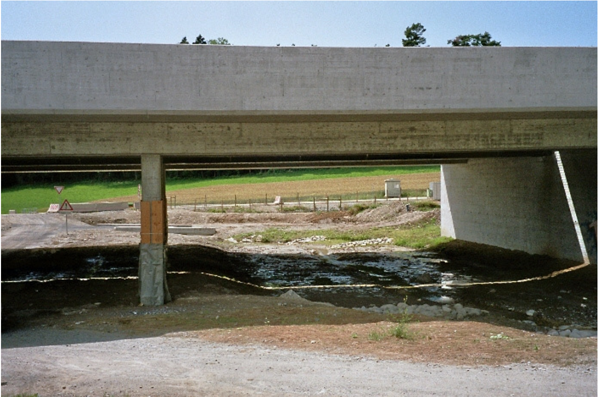
Schliffstrasse im Bau, Ausblick Richtung Chilchmatt (hinten rechts). Auf der rechten Bildseite Bachdurchlass. Quelle: Pfenninger/ Perrin, 2006.
